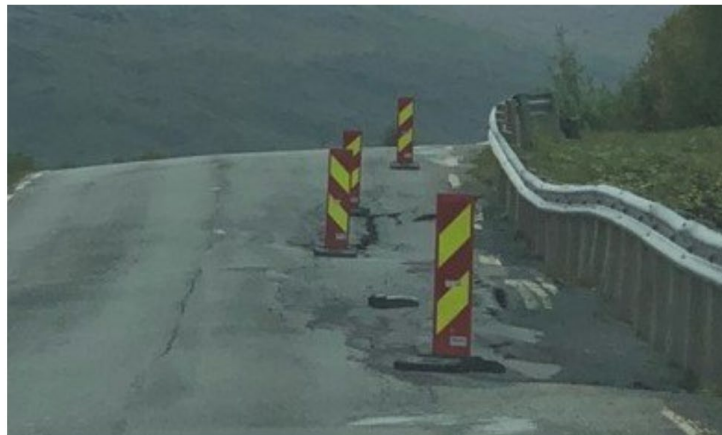
FORTVILET: Fylkesvegen har gått fra å være avlastningsvei til å bli fast inventar i Anne-Marie Isaksens mareritt. Foto: Privat
