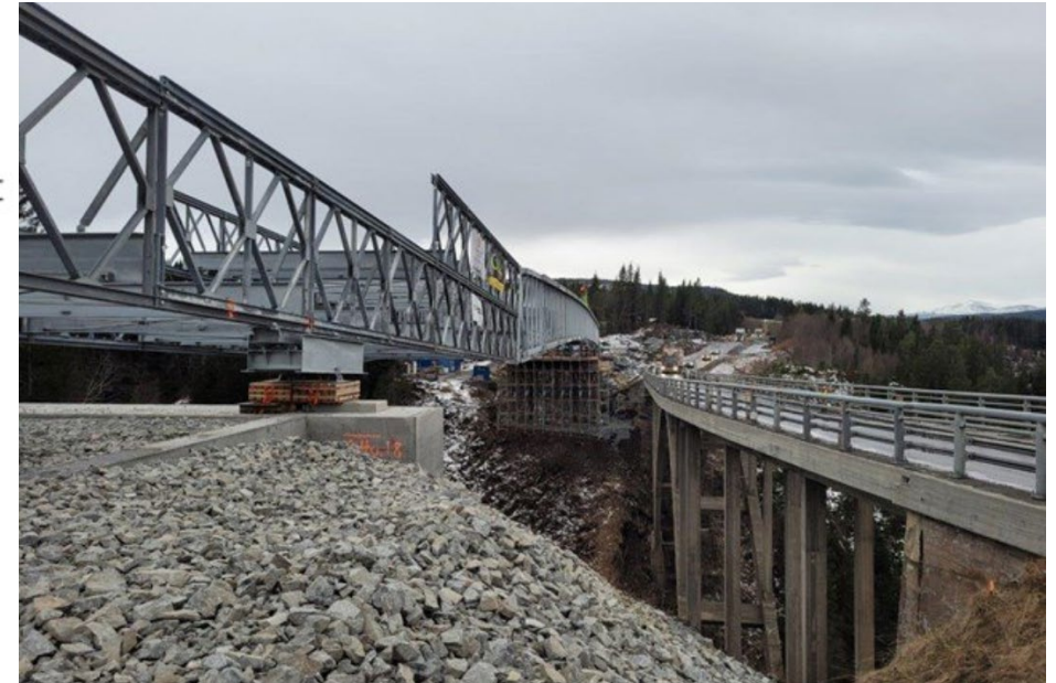
MAKS 5 TONN: Stavåbrua i Rennebu har skader på konstruksjonen. Derfor er det omkjøring for kjøretøy over 5 tonn. Foto: Karoline Valle / Statens vegvesen
