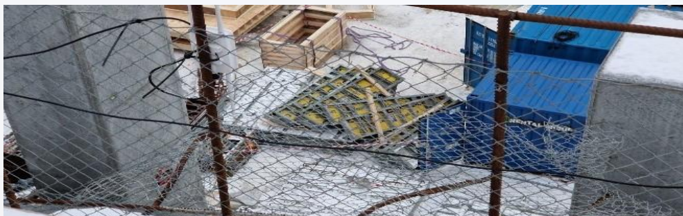
2 Systemforskalingen etter hendelsen
